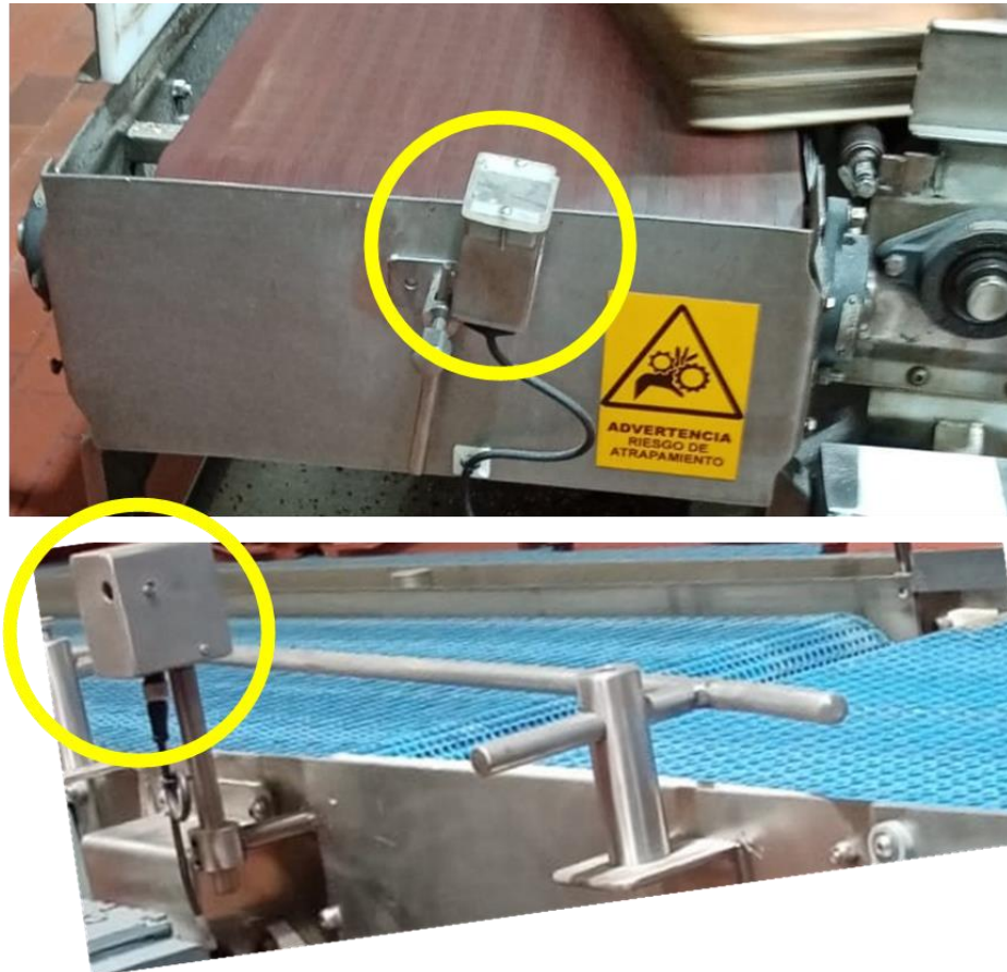
Ilustración 25 Celdas de paro automático
