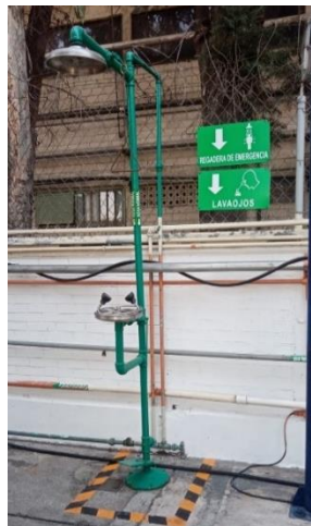
Fuente. Imágenes reales de las instalaciones de la empresa, 2025
