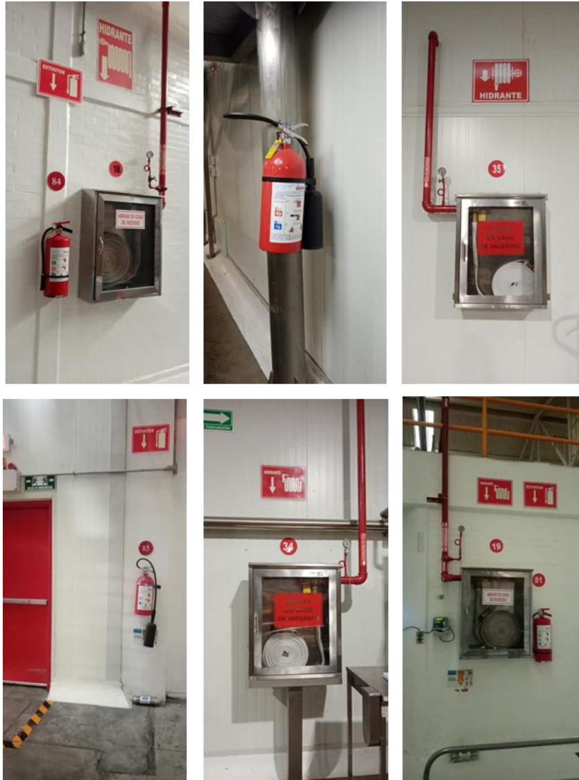
Fuente. Imágenes reales de las instalaciones de la empresa, 2025
